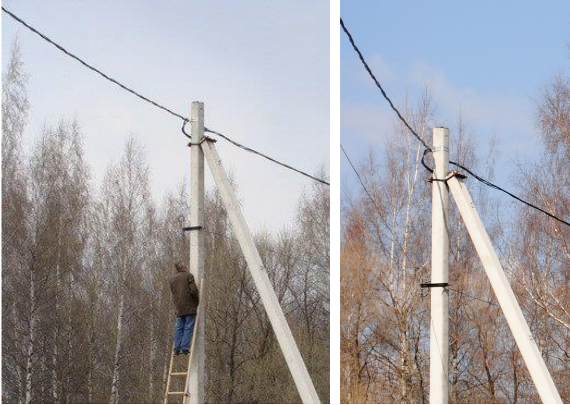
Linia energetyczna koło stacji benzynowej - zerwana i naprawiona.
